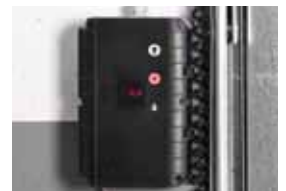
Steuerung - Quadro elettrico
